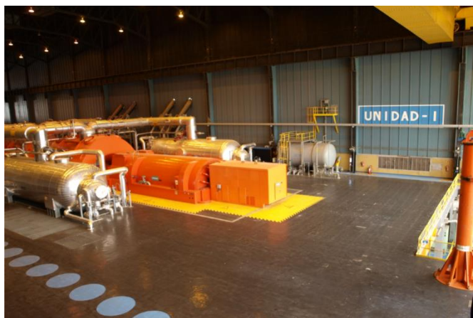
Edificio de Turbinas +14,60 de U-I
